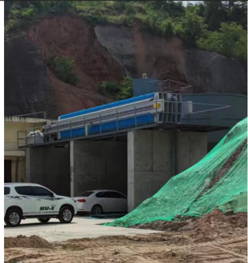
板框压滤机已安装，所在废水厂房未建
