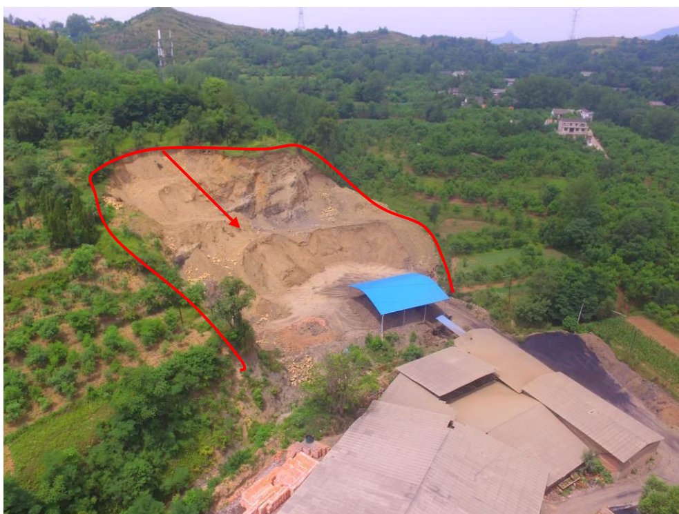
照片 3-1 H1 滑坡隐患
