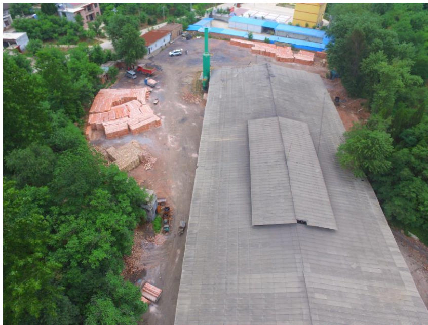
照片 3-3 工业场地损毁现状
